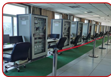
低压回路故障排除实训基地
